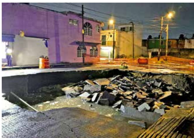
El cuerpo de Daniel, de 15 años, quedó colgado de la viga de un desagüe (derecha).
